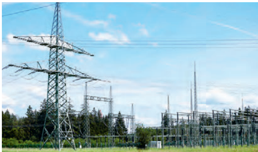
Umspannwerk der Firma Tennet.
