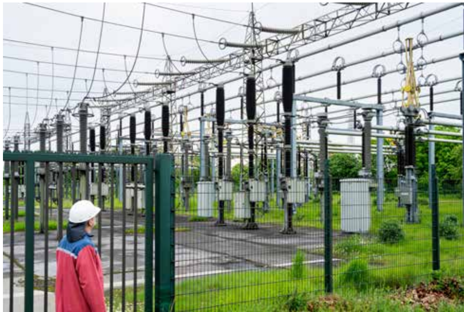
Eigenes Umspannwerk von TRIMET in Essen: Der Aluminiumhersteller steht allein für ein Prozent des gesamten deutschen Stromverbrauchs.
